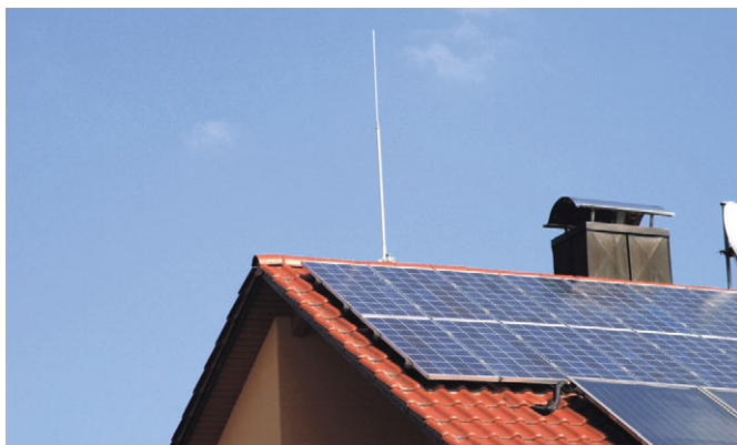
Защита надстроек на кровле с помощью молниеприёмников
