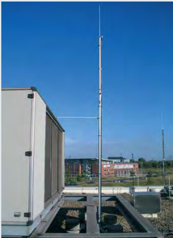
Изолированная система молниезащиты, расположенная около надстройки на крыше, с HVI® проводником.
